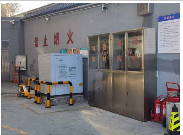
三次油气回收装置
